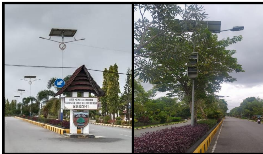
Gambar 1. Pemanfaatan energi solar/surya untuk lampu jalan 120 Watt pada Kota Masohi
